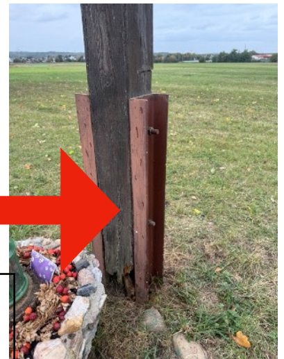
Verfaulte und verschimmelte Stelle (alles Holz, das hinter dem rechtem Eisen steckt - 80 cm hoch)
