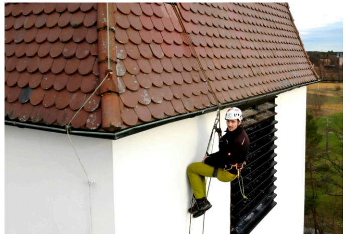
Archivbild von 2020: Johannes Pickart (erfahrener Sport-Kletterer und Alpin-Bergsteiger) begutachtet die Schäden, die der Sturm „Sabine“ am Kirchturm der Pfarrkirche verursacht hat.
