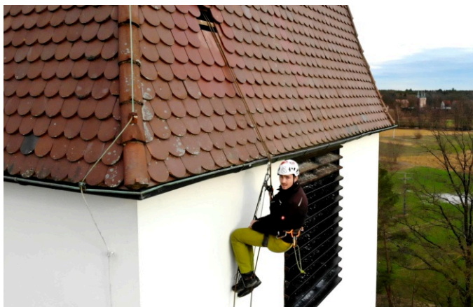
Archivbild von 2020: Johannes Pickart (erfahrener Sport-Kletterer und Alpin-Bergsteiger) begutachtet die Schäden, die der Sturm „Sabine“ am Kirchturm der Pfarrkirche verursacht hat.
